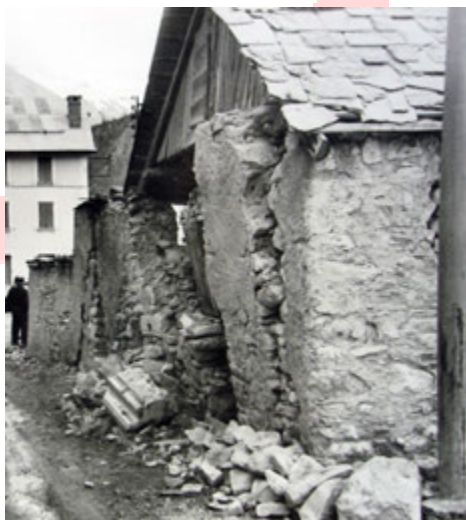
Dégâts suite au séisme de 1959 - Commune de Saint-Paul-sur-Ubaye © Nice Matin
