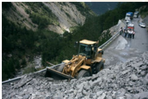
Eboulement à la Rochaille - Commune de Meyronnes © Service Restauration des terrains de montagne (RTM) des Alpes-de-Haute-Provence
