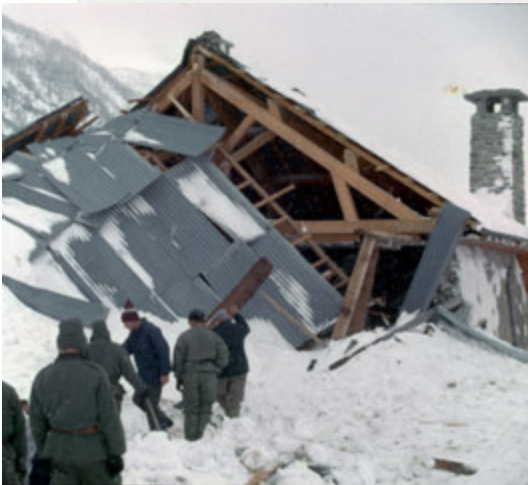
Avalanche de 1972 - Commune de Larche © Service Restauration des terrains de montagne (RTM) des Alpes-de-Haute-Provence
