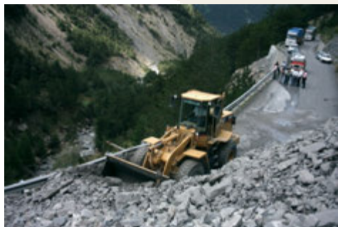
Eboulement à la Rochaille - Commune de Meyronnes © Service Restauration des terrains de montagne (RTM) des Alpes-de-Haute-Provence
