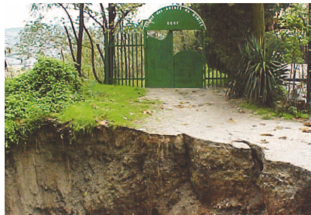
Nice Cimiez : Risque affaissement/effondrement (cavités) Source : Ville de Nice
