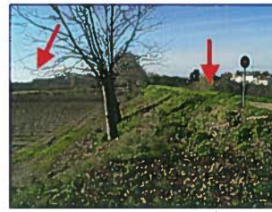
Digue de protection du village, lieu dit "les Crouzettes" sur la gauche
