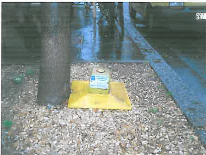
Borne canalisation de transport
