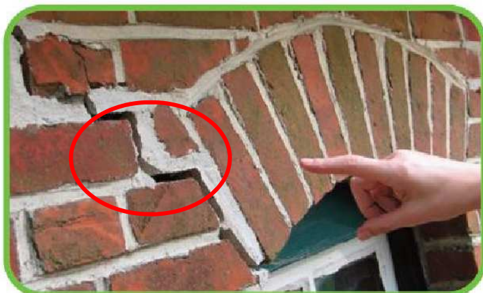
Fissure sur une maison suite à une période de sécheresse
