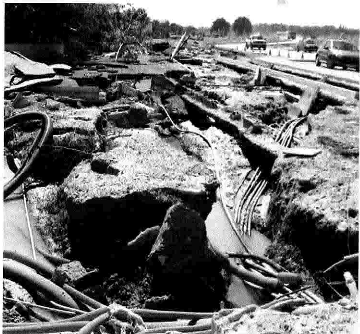
Dégâts sur les réseaux, inondations de Septembre 2002 Sources Syndicat du Vidourle 2009
