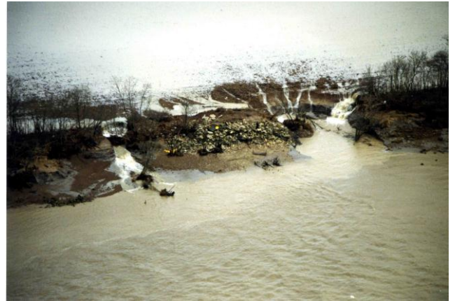
DDE 33 - Rupture de digue Tempête de 1999 dans le nord Blayais
