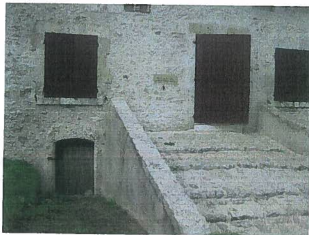
Repère de crue sur la ferme de Maisonneuve
