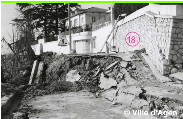
Janvier 1961 : chaussée effondrée sur l'avenue de l'Ermitage
