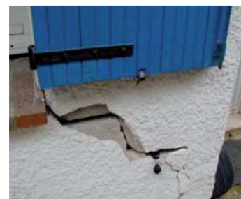
Des phénomènes de fissuration des murs
