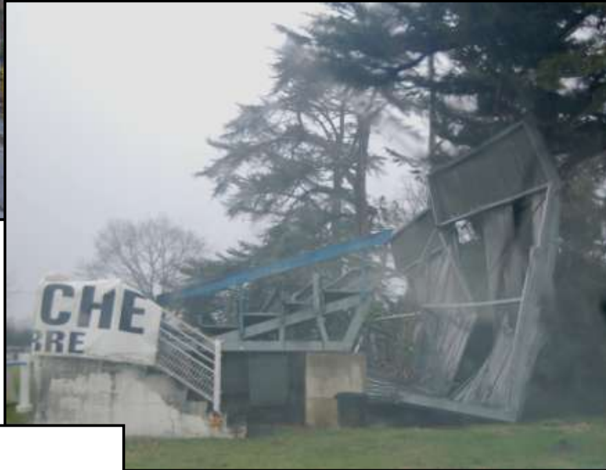
Effondrement d'édifice – Stade Menoni
