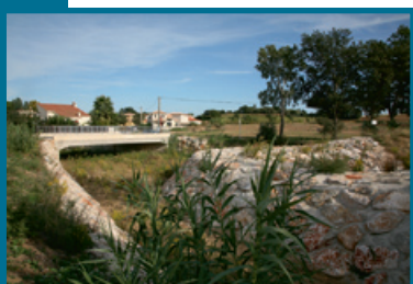
Pont cami d'Als Horts et bassins d'orages
