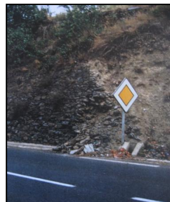
Éboulement rocheux sur la RN116, (Source : RTM66)
