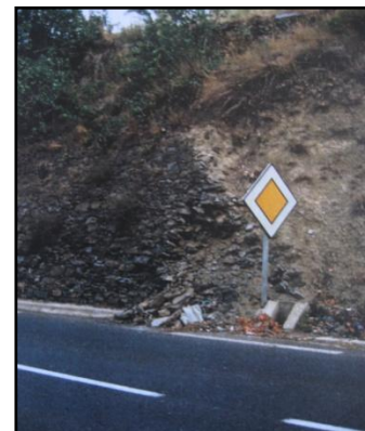
Éboulement rocheux sur la RN116, (Source : RTM66)
