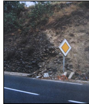
Éboulement rocheux sur la route nationale 116, (Source : RTM66)
