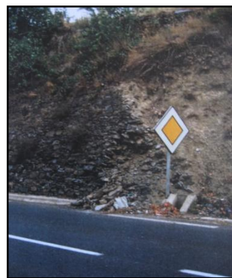
Éboulement rocheux sur la route nationale, (Source : RTM66)
