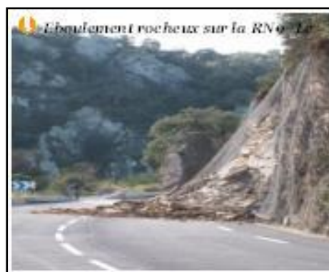
Éboulement rocheux sur la Route nationale 116.
