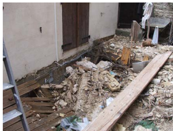
Eboulement décembre 2008 (Source : Mairie d'Apt)
