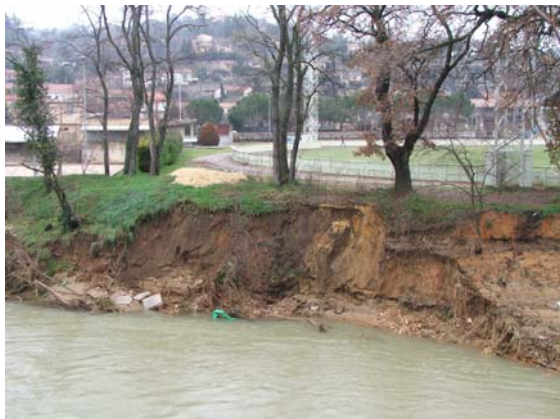
Crue de déc. 2008 : dégât des eaux: (Source : Mairie d'Apt)
