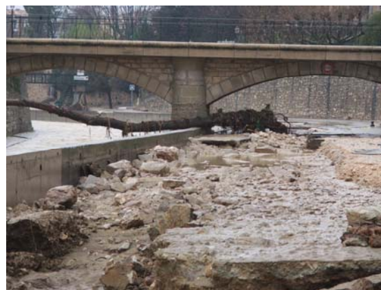
Embâcles au Pont de La Coquière (source : Mairie d'Apt)
