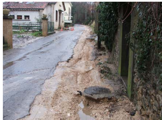
Dégât des eaux décembre 2008 (Source : Mairie d'Apt)
