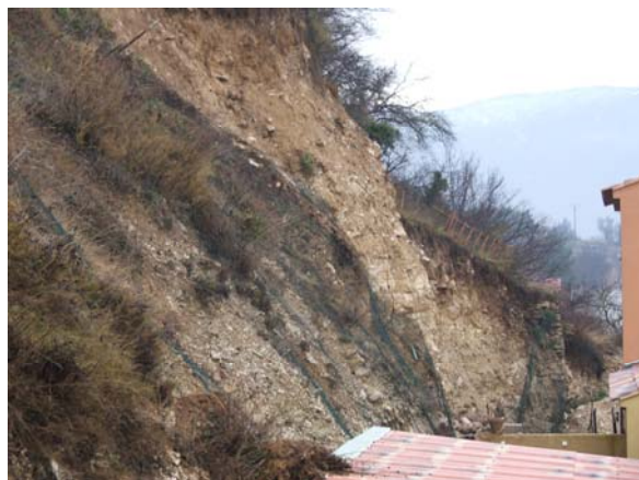
Eboulement décembre 2008 (Source :Mairie d'Apt)
